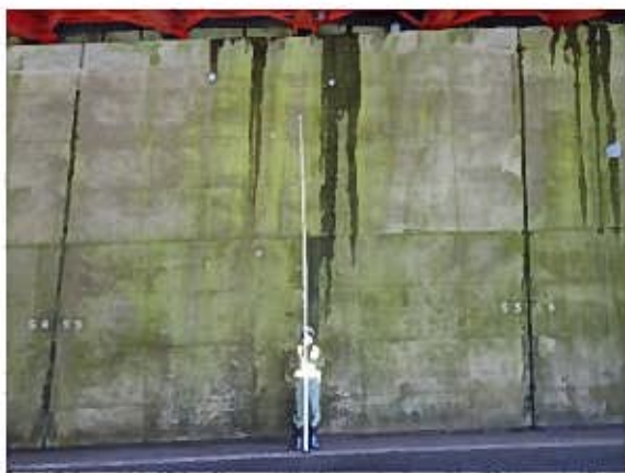
山側漏水状況（壁面全体）
