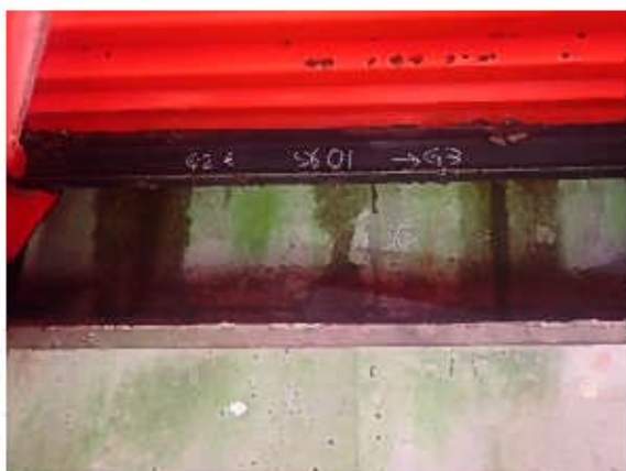
山側漏水状況（受台付近）
