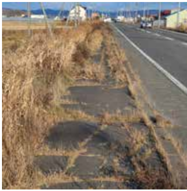
△アスファルトがめくれ草が生えた通学路
