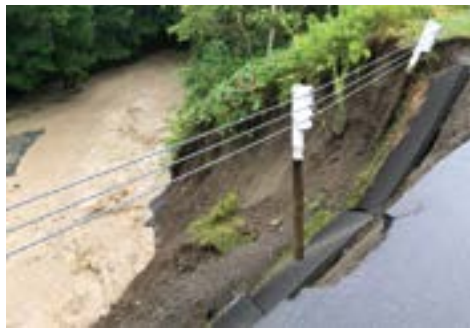
▷令和4年8月豪雨による被災した町道豊糠糠平線
